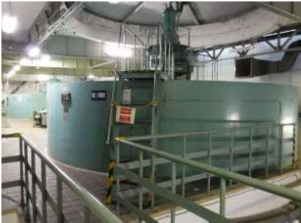
発電機（工事前）
