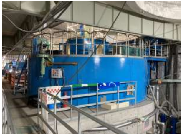
発電機（工事後）
