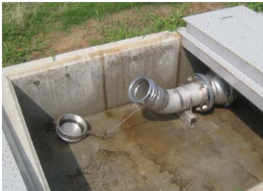
ホース接続部
