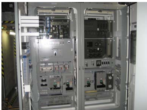
同時投入防止用切替盤
